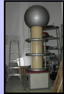
Fonte de AT do implantador de íons do IFUSP (400 kV)
